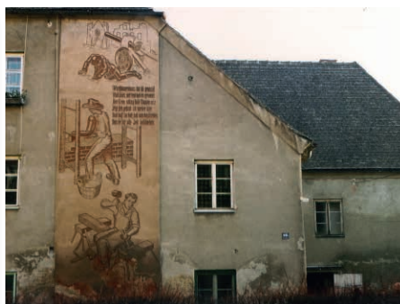
Desolater Zustand vor der Revitalisierung 1995
